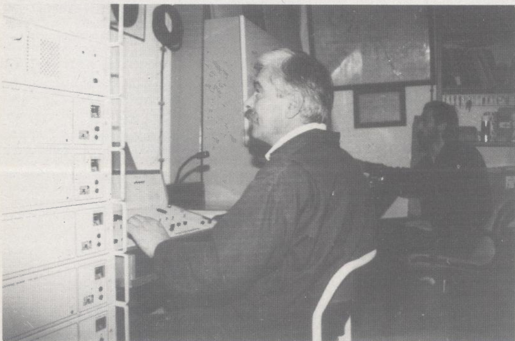
U središnjici upravljanja elektrostrojnima uređajima
